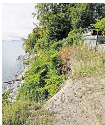
Rügens Steilküste bröckelt bedenklich. Auch Häuser sind bedroht. Foto: dpa
